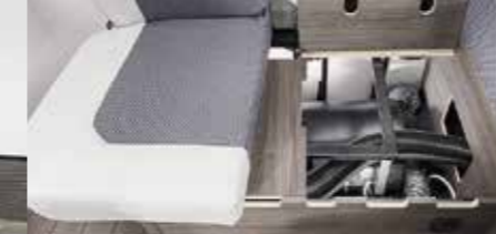
4 Die im Wohnraum platzierte Dieselheizung
